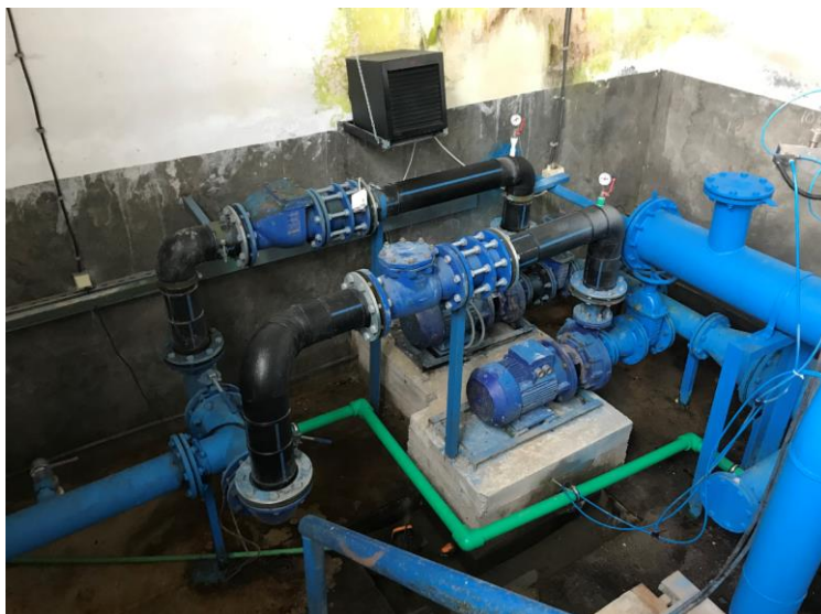
Слика. 15. Црпна станица P1 – Рудине
