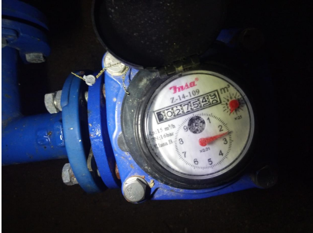
Слика.30. Водомер на излазном цевоводу
